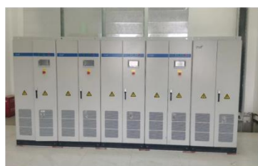
河北建投崇礼大规模风光储互补制氢关键技术与应用示范项目
