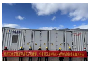
西藏昌都8MW/40MWh储能项目
