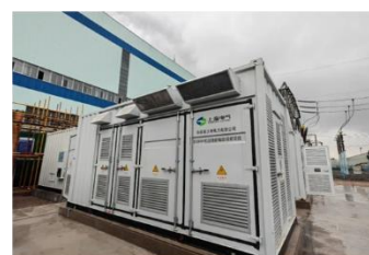
江苏张家港沙洲17.5MW/17.5MWh储能调频项目
